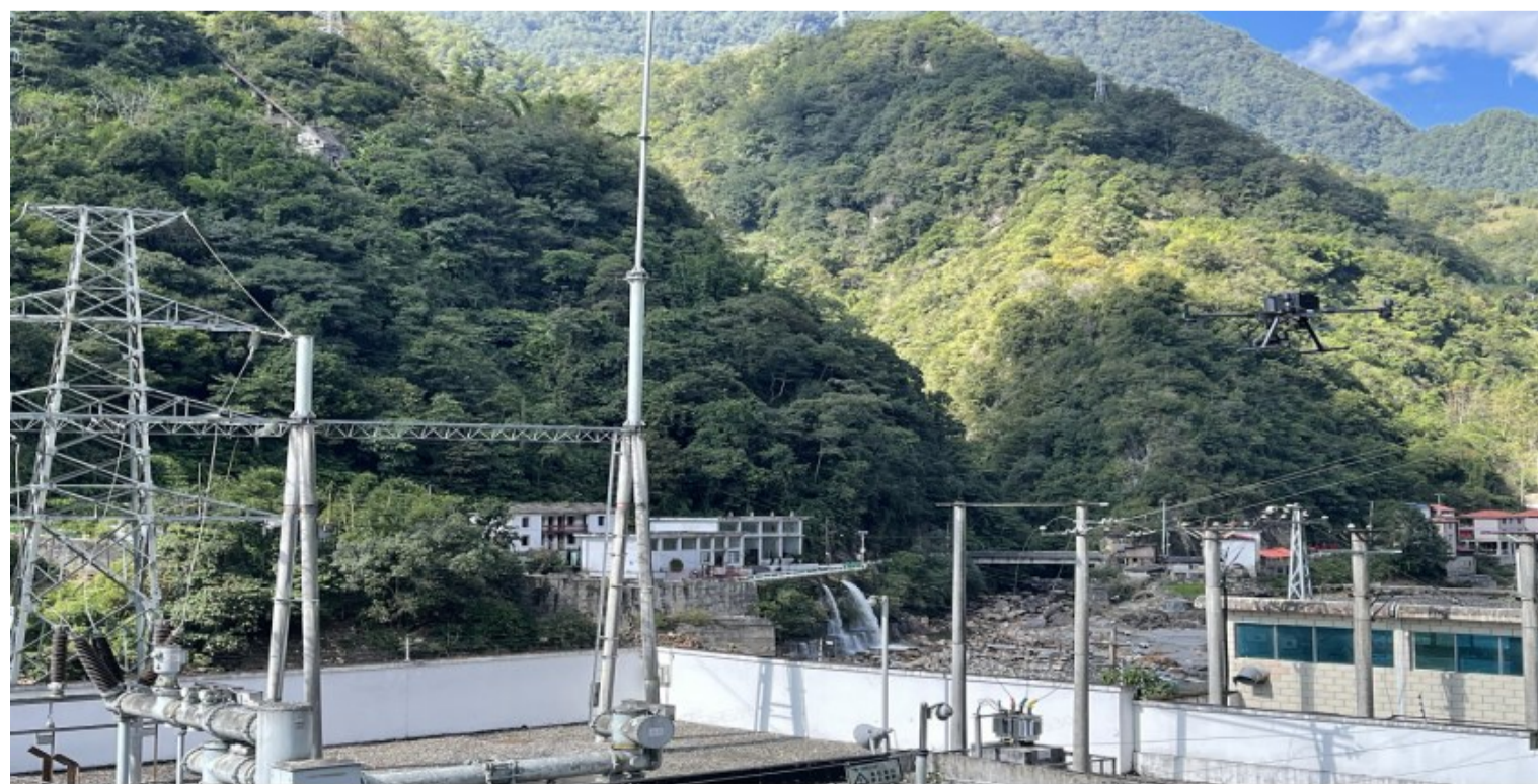
近日,怒江供电局在110KV马吉开关站和35KV马吉变电站首次采用无人机巡检技术对变电站进行巡视,标志着怒江供电局作为全省第一梯队拿到了变电站无人机自主巡检的“入场券”。据介绍,无人机不但能完成大部分常规巡检作业,还能提高电力线路巡检及维护效率,保障电力运行稳定。(本报记者 黎海月 通讯员 石光 摄)
